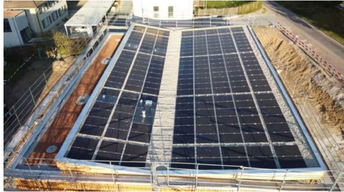
PV Anlage Dornackerweg 5, Huttwil
